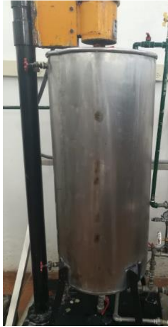
Figura 1. Tanque de alimentación.
