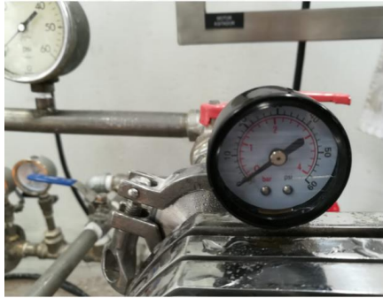
Figura 5. Medidores de presión.
