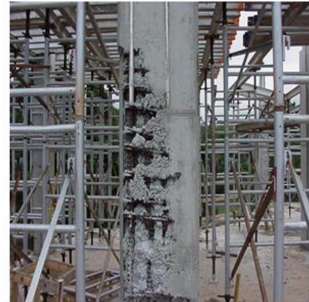
Segregación del concreto
