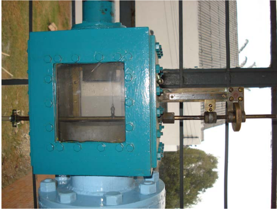
DETALLE DEL TUBO DE PITOT
