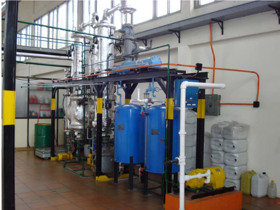
CONJUNTO DE EVAPORADORES
