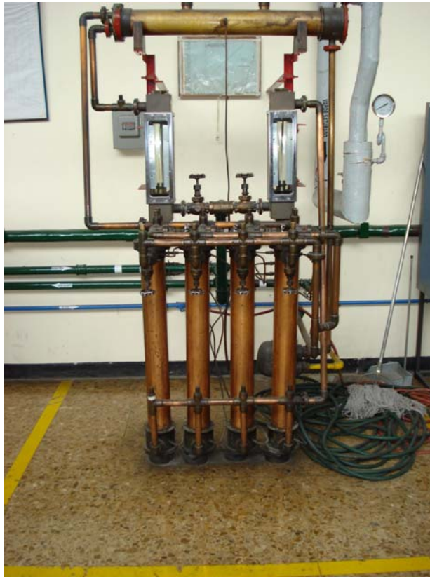
INTERCAMBIADOR DE TUBOS Y CORAZA
