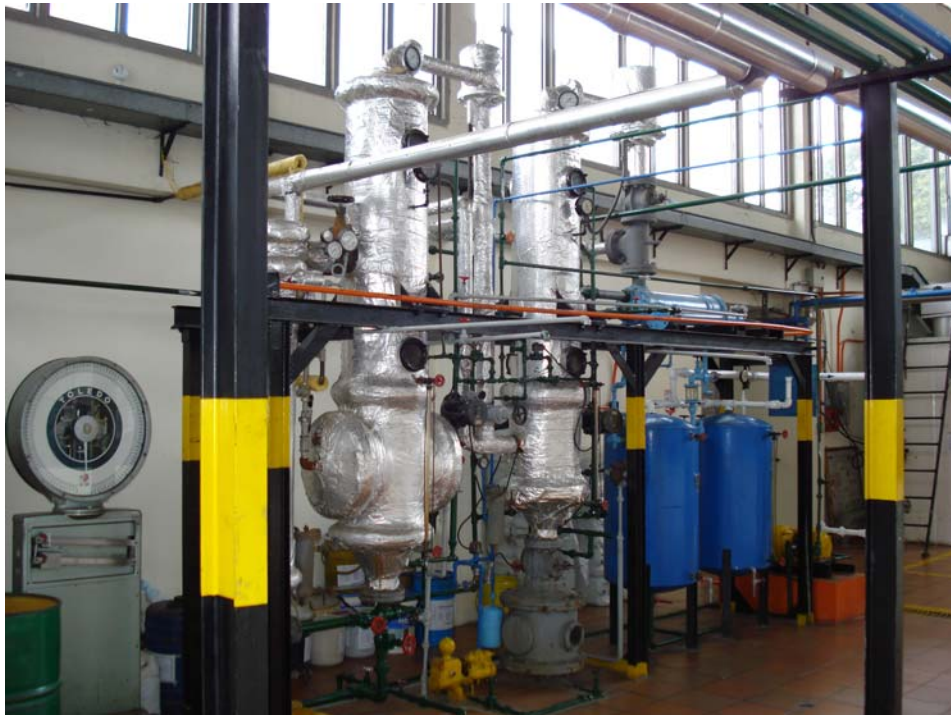
CONJUNTO DE EVAPORADORES
