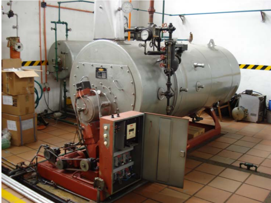
CALDERA DISTRAL DE 50 BHP
